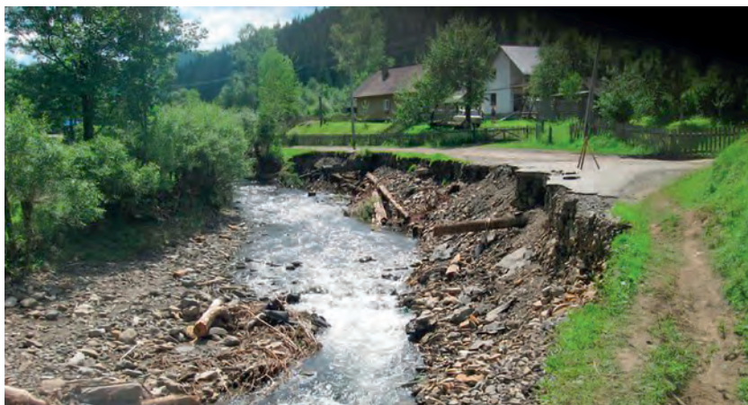
Рис. 10.1.2. Дорога в с. Лопушне, зруйнована бічною ерозією
